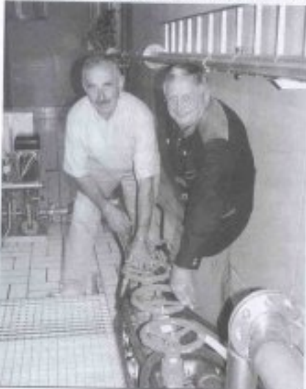
Bgm. Ignaz Leonhartsberger und Wasserwart Ignaz Hilber kontrollieren laufend die Wasserversorgungsanlage. Immerhin versorgt die Gemeinde St.Oswald an die 200 Haushalte mit bestem Trinkwasser
